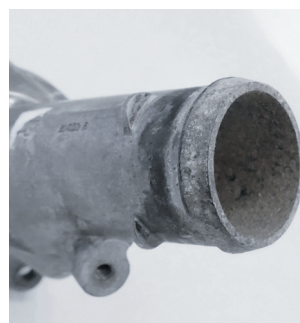
Ilustracja 3: Przed montażem starannie oczyszczenie skorodowanej powierzchni
